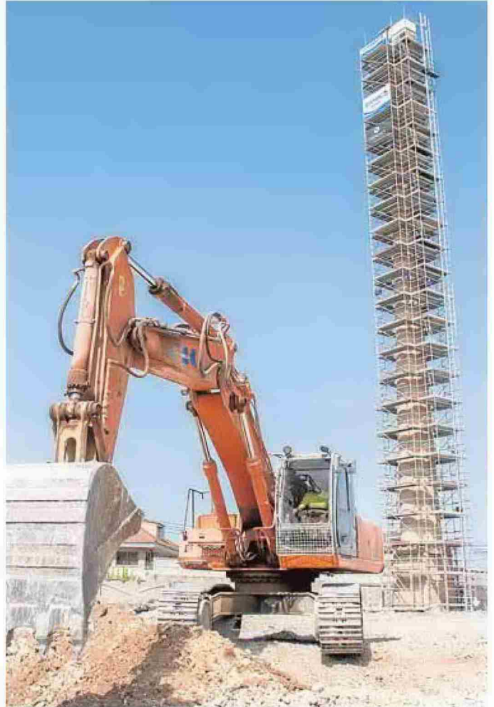
La chimenea de la carretera de El Palmar (Murcia), que alcanza los 45 metros de altura, cubierta de andamios para su restauración. ROS CAVAL
